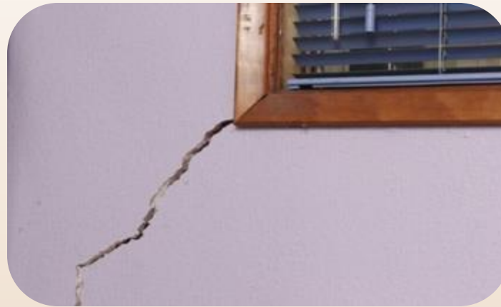
Dommages sur nos infrastructures
